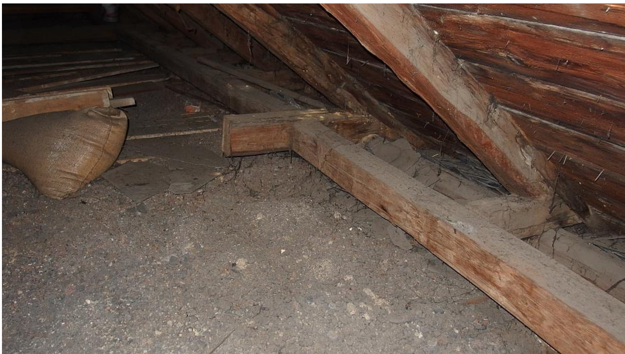
Zbytek vyřezaného vazného trámu na straně ulice
