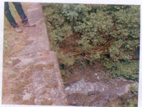
Zárubní zeď – doplnit zábradlí
